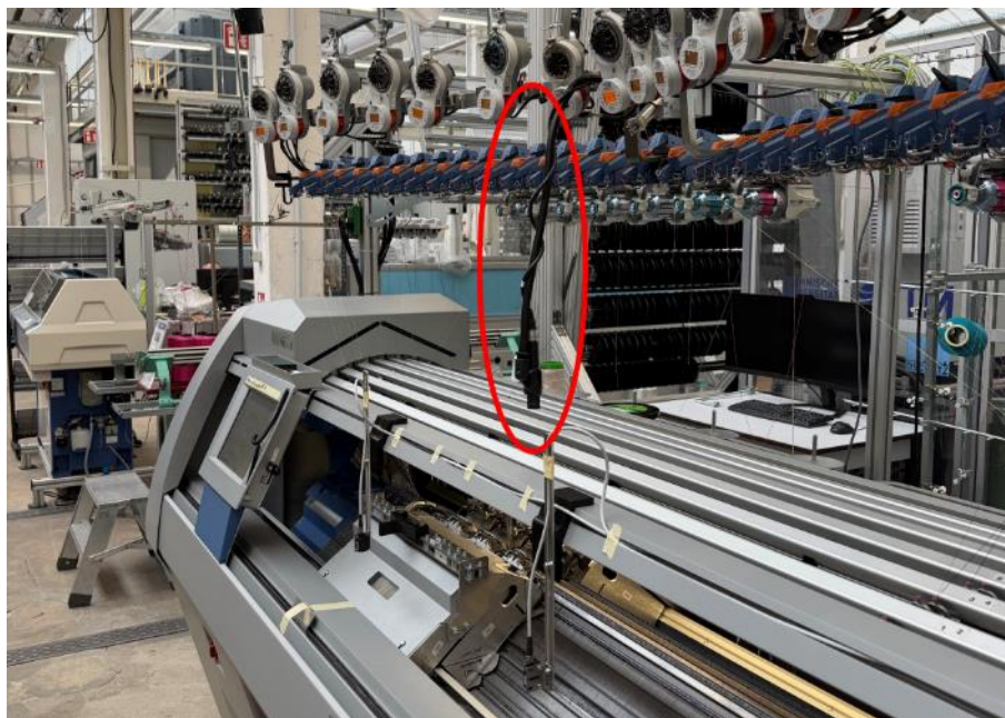
Abbildung 3: Montiertes Richtmikrofon SE8 (roter Kreis) über der Strickstelle an der Maschine
